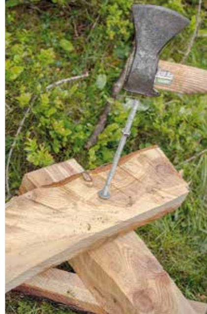
Verschraubung. Die beiden Aufleger für das Plateau werden jeweils mit der dazugehörigen Spreize am Boden verschraubt.
